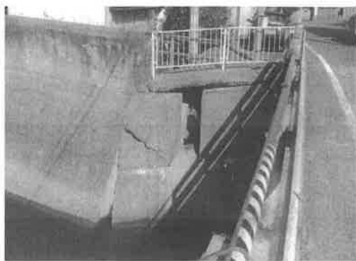
▲護岸の亀裂箇所
