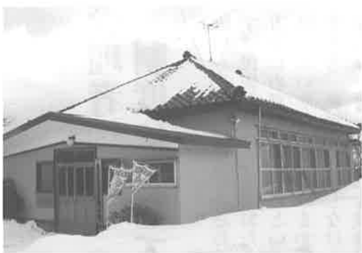
▲ 分館整備事業補助金で屋根が整備された中野分館（仁賀保）
