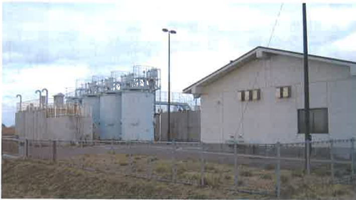
横根浄水場 (仁賀保地域)
