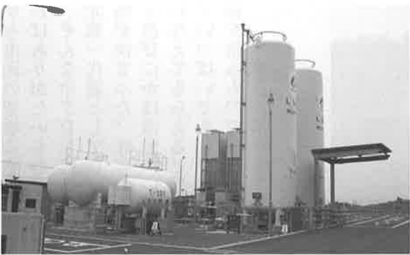
▲ LNGサテライト基地
