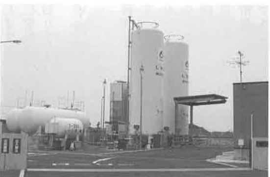
▲ LNGサテライト基地 (ガス事業)
