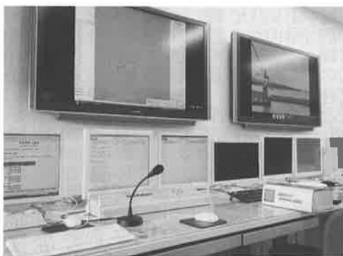
▲市防災課に設置している無線統制室
