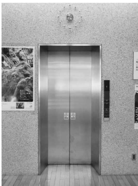
▲エレベーター（象潟庁舎）
