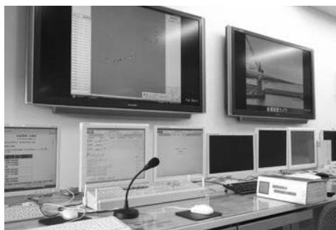
▲防災課に設置している無線統制室
